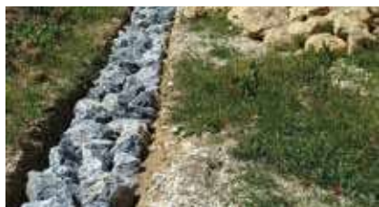
Pierres de fondation déposées avant le coulage du béton de chaux hydraulique et de graviers concassés.
